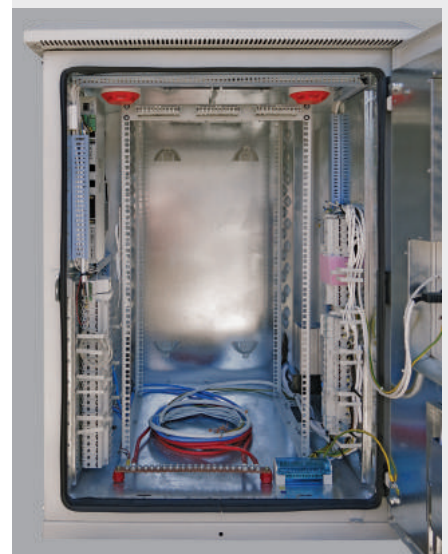
Внутренний объем шкафа
